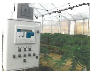
Automatización del riego
