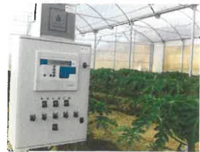
Automatización del riego
